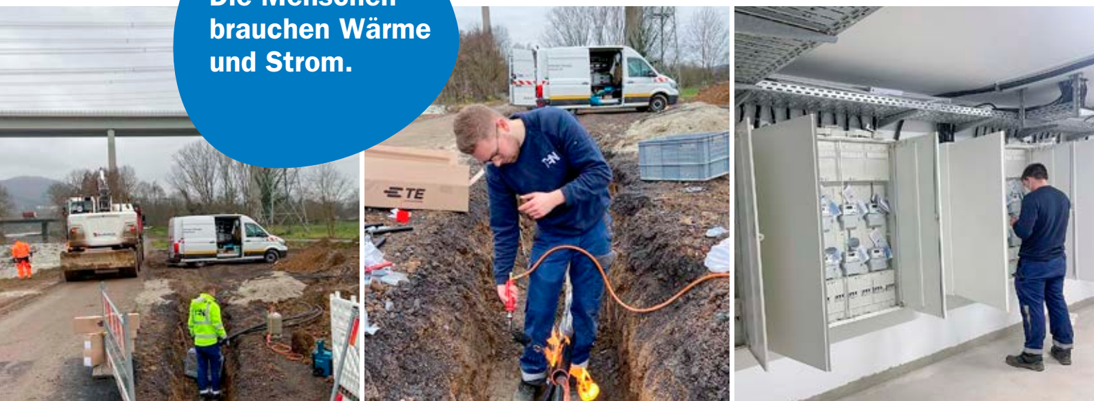
Leitungen legen und Zähler montieren: Unsere Kollegen Phillip Elixmann und Sebastian Beyer halfen vor Ort die zerstörte Infrastruktur wiederherzustellen.
